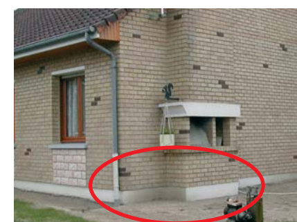
Zone où la destructuration des sols a été la plus forte.
