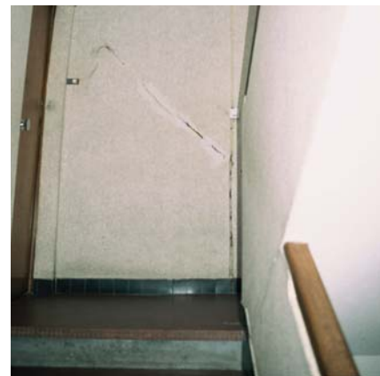
Multiplis fissures dans les cages d'escalier...
