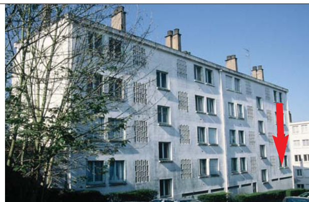
Affaissement marqué de l'ouvrage sur son pignon Est.
