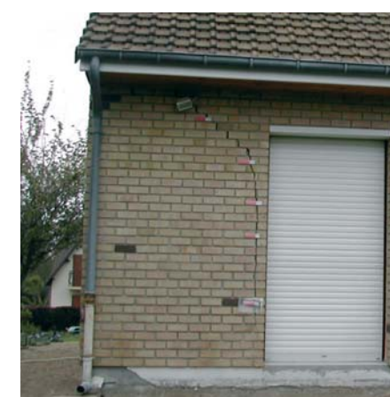
Fissure sur la façade arrière de la maison.
