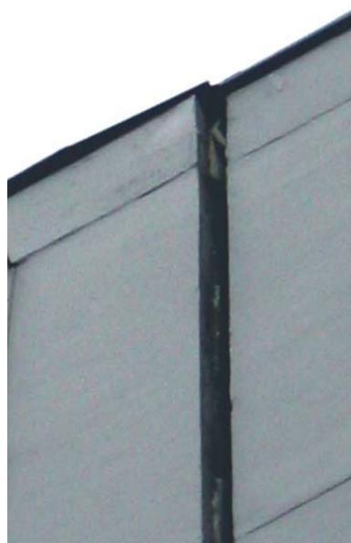
Joint de dilatation avant réhabilitation
