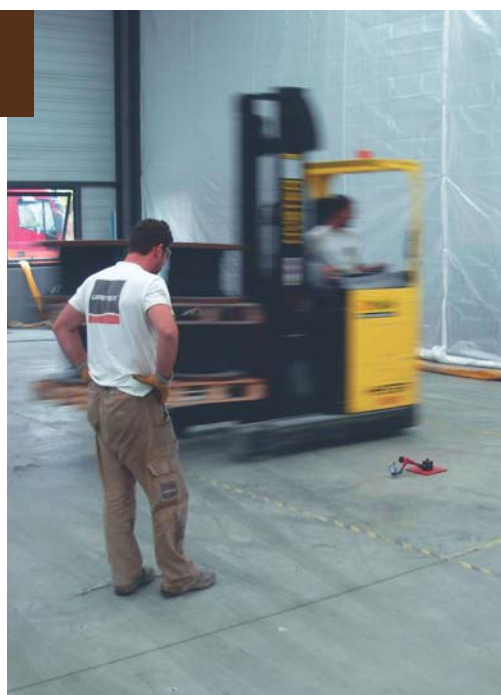
Contrôle du battement au passage d'un chariot élévateur, à l'aide d'un comparateur.
