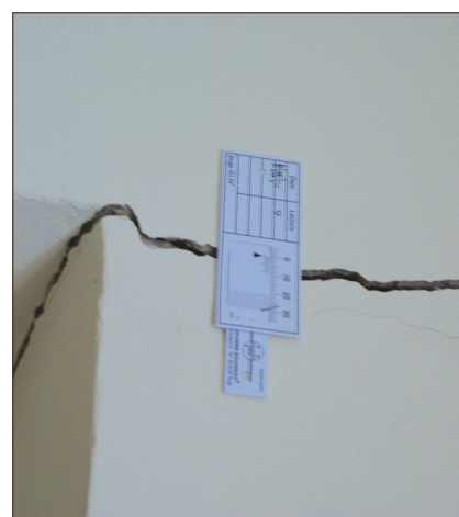
Détails de l'affaissement de la dalle et des fissures
