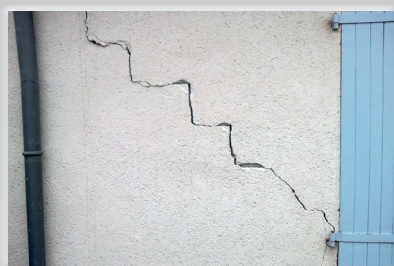
Fissure en escalier
